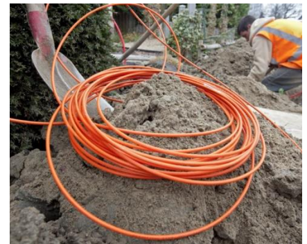
▲ De aanleg van een glasvezelnet. Als de gemeenteraden in Rivierenland akkoord gaan, start de aanleg dit jaar van start. © ANP XTRA
